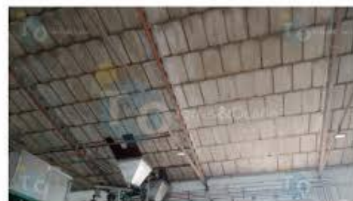
Falsos techos de fibrocemento
